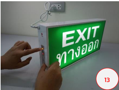
ทดสอบกดสวิตช์ TEST แสงสว่าง ป้ายต้องสว่างต่อเนื่องเช่นกัน
